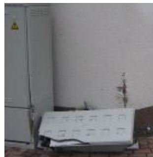
Abbildung 22: Durch Verkehrsunfall beschädigte EnAs
