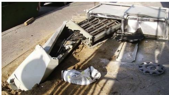
Abbildung 21: Durch Verkehrsunfall beschädigtes MFG
